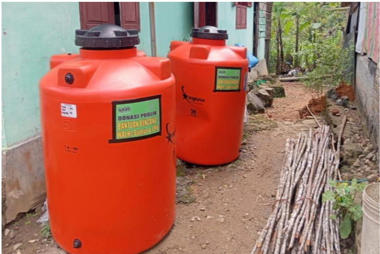
Penyediaan tandon air di Desa Bonan Dolok, Kecamatan Sitahuis, Kabupaten Humbang Hasundutan.
