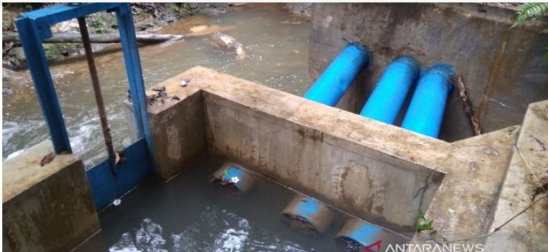
Fasilitas reservoir pendistribusian air bersih dari sumber air Sungai Aek Nalas yang dikelola PDAM Mual Natio, di Desa Sabungan Ni Huta IV, Kecamatan Sipahutar, Taput. (ANTARA/Rinto Arionang)
