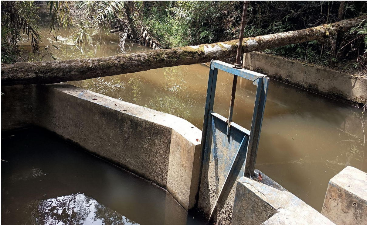
Bak penampungan Sumber Air Bersih Aek nalas yang berada di hilir sumber air, lalu disalurkan melalui pipa ke Kecamatan Sipahutar dan Siborong-borong. Foto: Maruli_Sopo Tano Batak. 2025).
